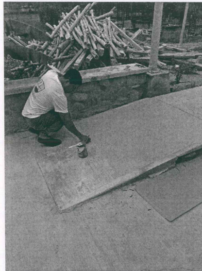
Pintura reglamentaria en rampa de acceso para discapacitados en entrada principal del instituto
