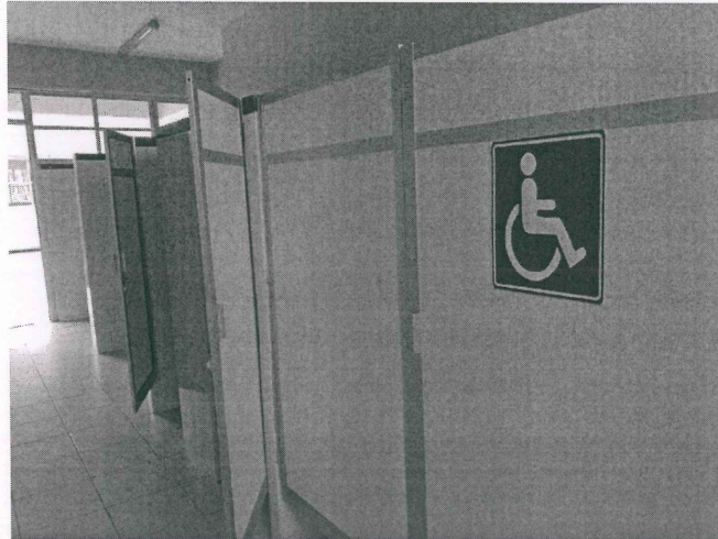
Señalética para personas con discapacidad en los baños.
